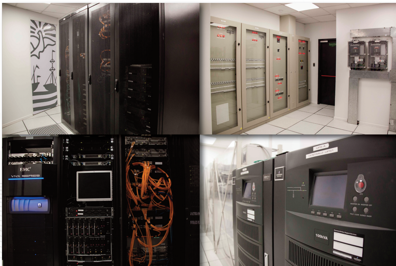
Centro de Operaciones de Red (N.O.C.)
